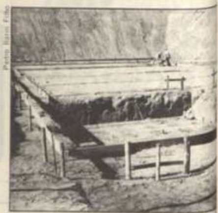
Operários do SAAE trabalham na concretagem da fundação das unidades de tratamento do Sistema Turvo.
