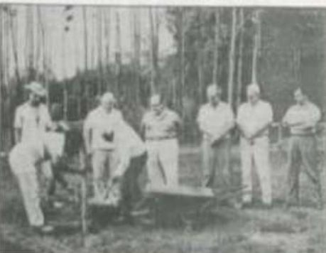
O professor Arlindo lançou uma pd de massa na fundação da obra.
