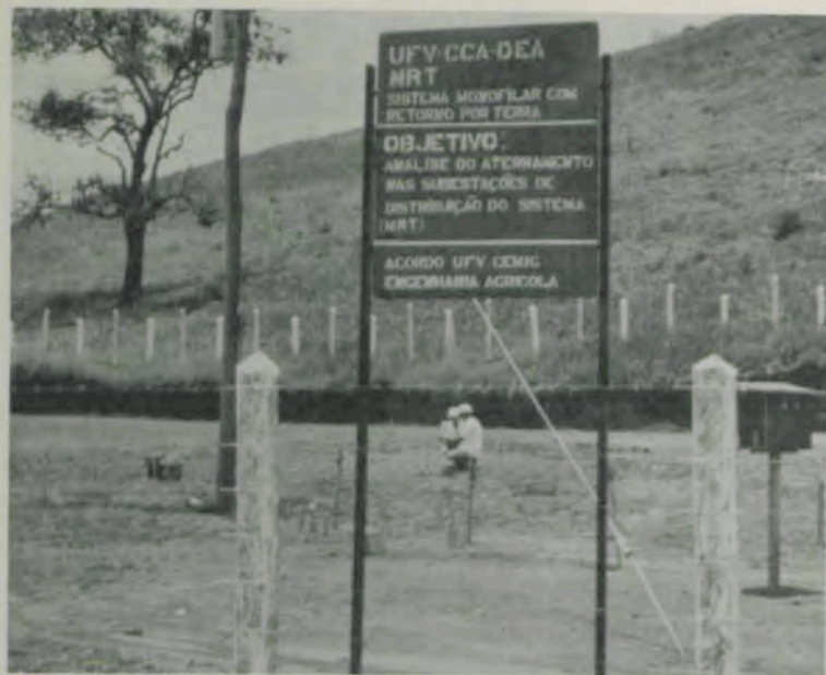
A área experimental, com a subestação de distribuição, durante coleta de dados.
