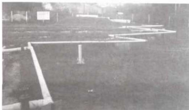
Tubulação de recalque.
