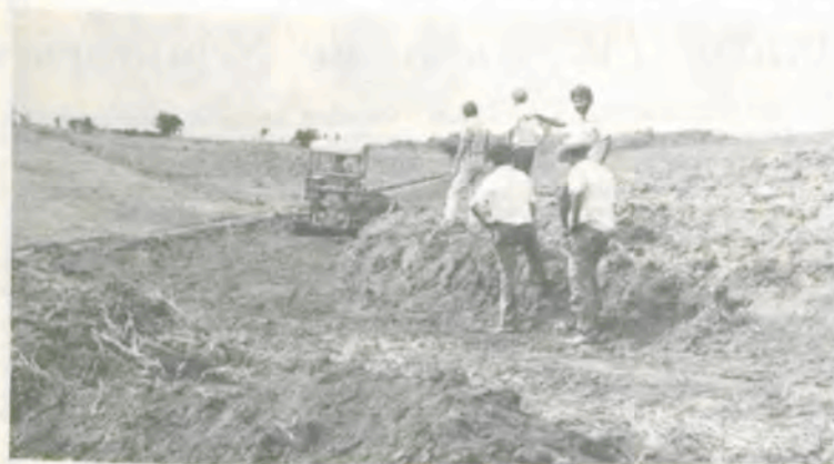
Estudantes de Agronomia da UFV orientando a construção de carreadores em nível.
